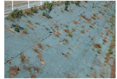
シートに穴が開いて雑草が生えている。
