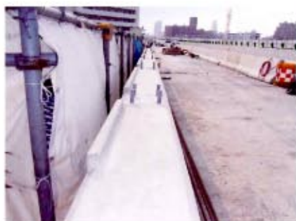
④天端付遮音壁アンカー
