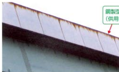
鋼製型枠の劣化状況
