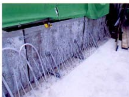
⑤設置状況
