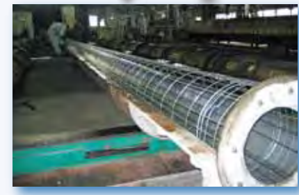
3. 型枠組立 型枠に離型剤を塗布し、足場基礎ねじ等の付属品を取り付けた後、鉄筋かごを組み込み、型枠を組み立てます。
